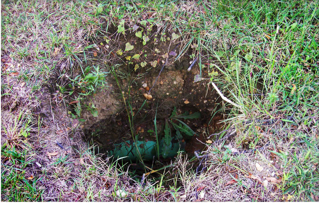
Grietas o agujeros en la presa (terraplen).
