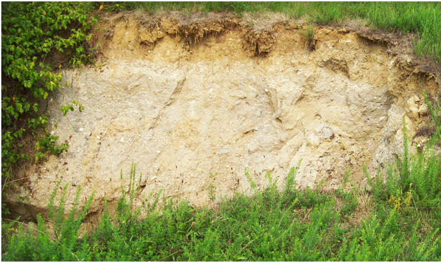
Erosión de la pendiente o falla de la presa (terraplen).
