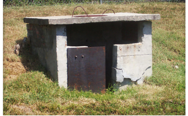
Estructura de control rota o dañada.
