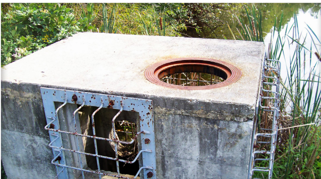
Falta la tapa del pozo en la estructura de control.
