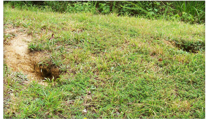
Madrigueras de animales en el terraplén de la presa; madrigueras de castores que bloquean las tuberías de salida.
